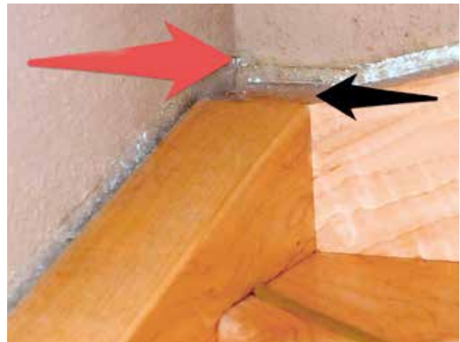
Im Vergleich zur ursprünglichen Einbauhöhe (roter Pfeil) hat sich die Treppe um mehr als einen Zentimeter gesenkt.
